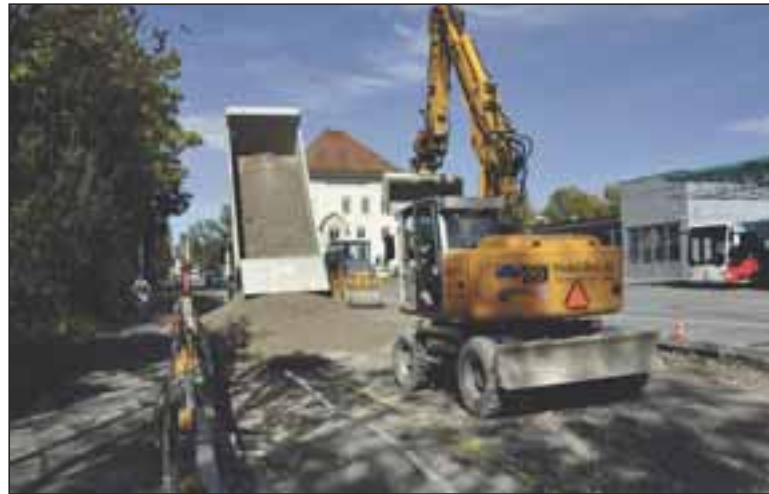
Der provisorische Belag für die Werkstrasse wies massive Schäden auf. Jetzt wird er durch eine definitive Lösung ersetzt.
