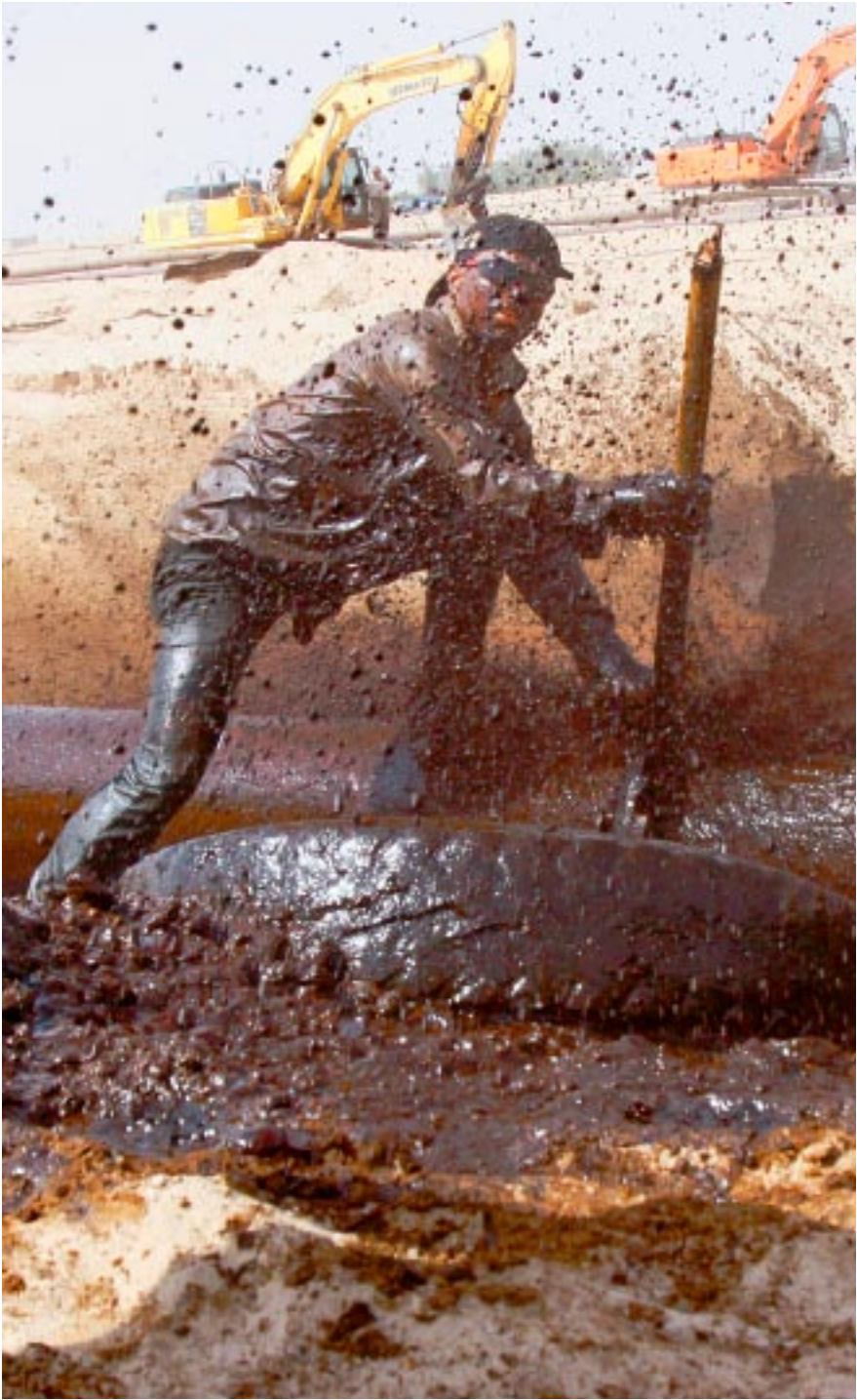
Im Rumaila-Feld im Süd irak repariert ein Arbeiter eine Pipeline, aus der Öl schiesst.
