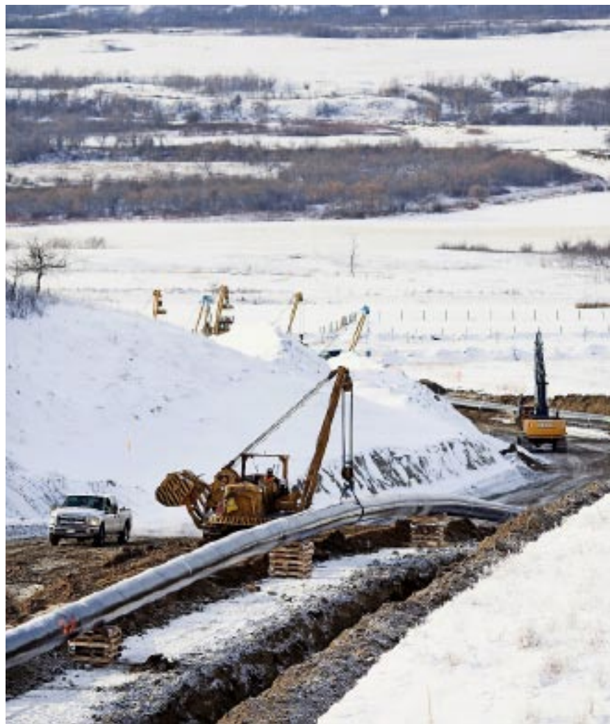
Bau einer Ölpipeline in der Nähe von Hardisty in der kanadischen Provinz Alberta.
